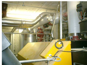
Pelletsfüllrohre im Heizraum
