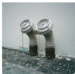
Füllstutzen im Aussenbereich
