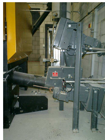
Fördereinrichtung Silo - Kessel
